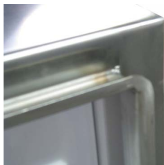
NEMA 3R Rain Gutter
